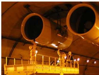
(施設)トンネル換気設備の点検
