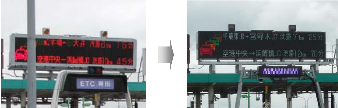
可変式道路情報板の更新
